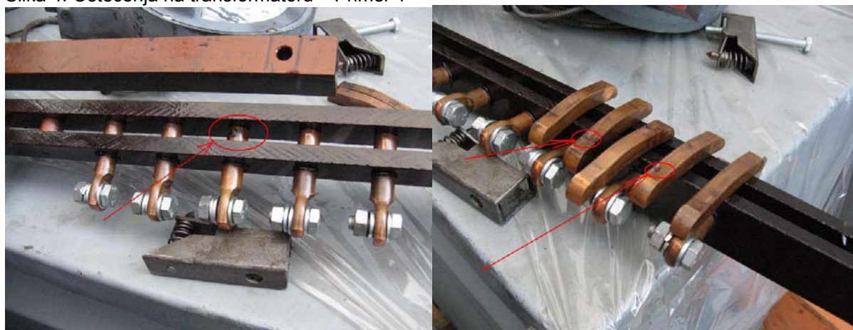
Slika 4. Oštećenja na transformatoru – Primer 1
